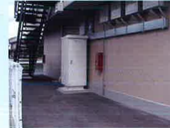
介護施設 様 蓄電池
