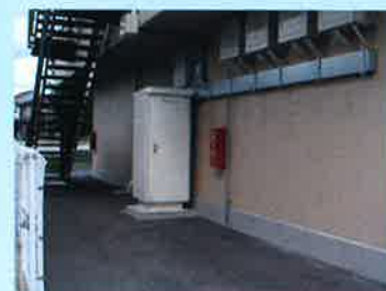
介護施設 様 蓄電池
